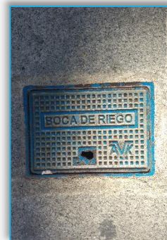
Veevarustuse sulgarmatuuri kape
